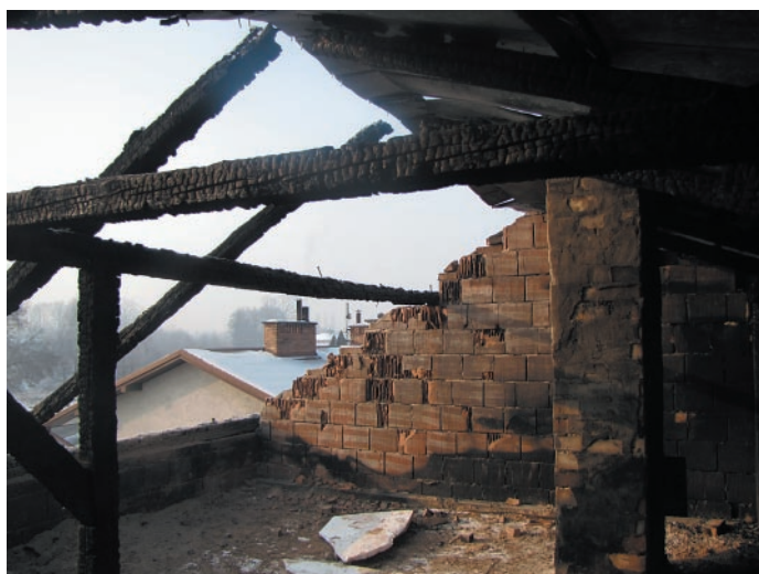
Tak wyglądał dach domu Wójtowiczów tuż po pożarze...
