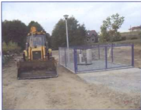
Przepompownia ścieków w Nowodworzu
