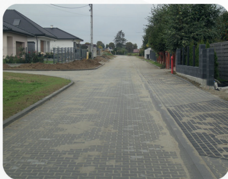
Ulica Sosnowa w Zgłobicach
